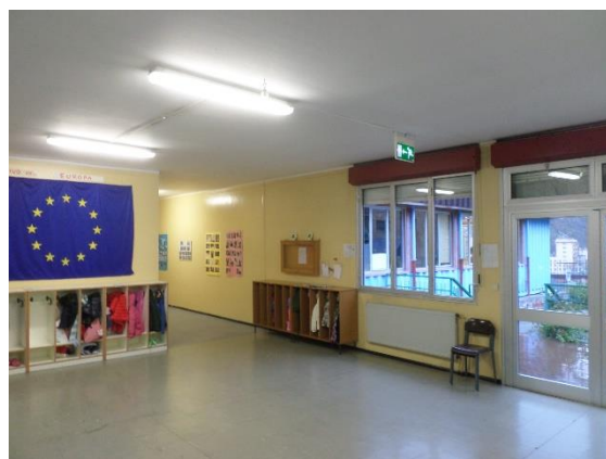
Figura 4.8 - Particolare dei corpi illuminanti
