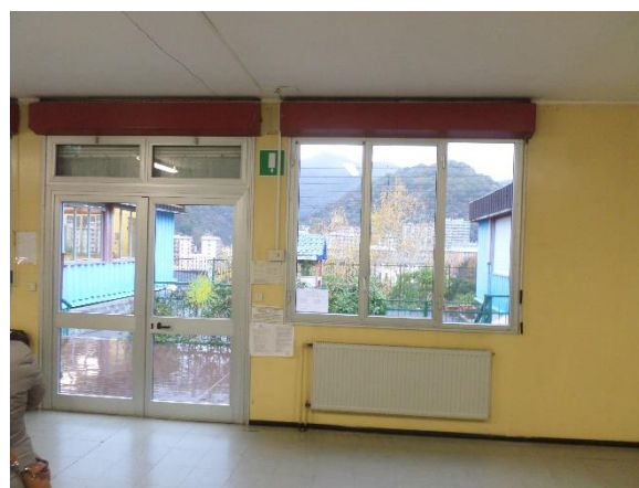
Figura 4.6 - Vista d'insieme dell'aula con i radiatori sotto finestra
