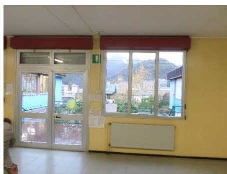
Figura 8.2 – Particolare radiatori attuali
