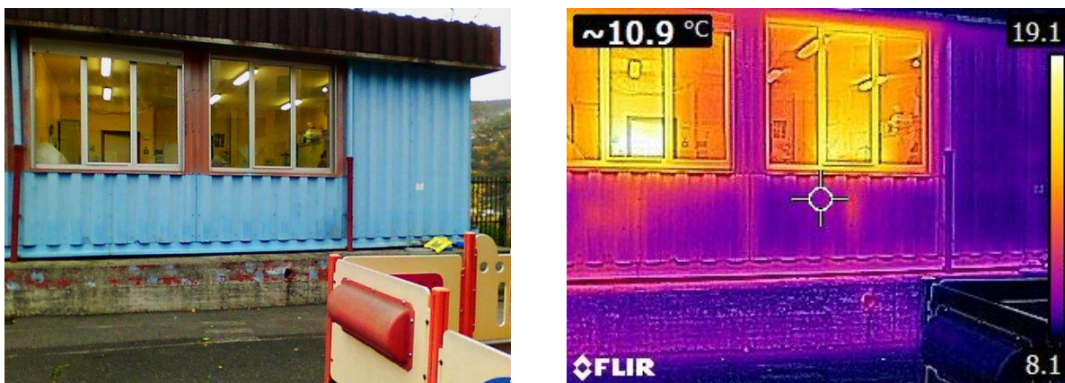
Figura 4.3 –Rilievo termografico delle pareti
