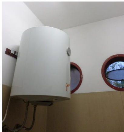
Figura 4.7 - Particolare del boiler elettrico per la produzione di acqua calda sanitaria]
